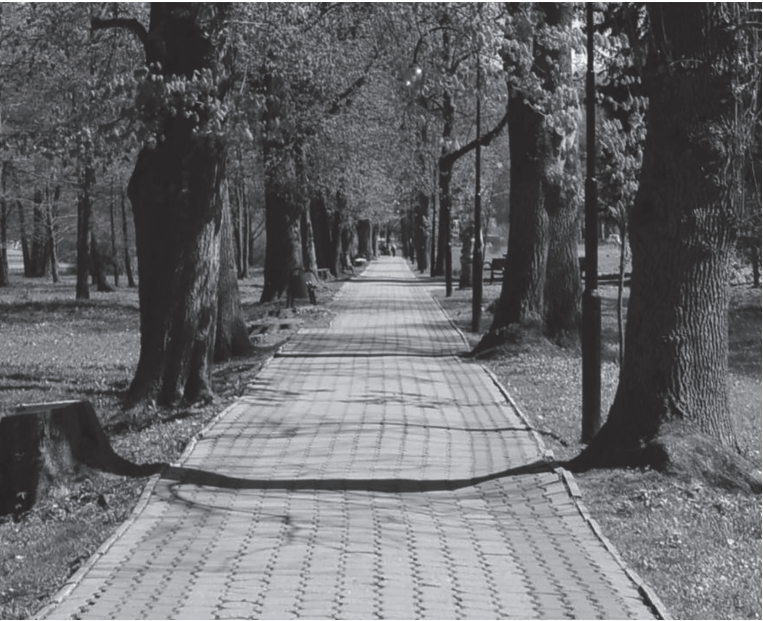
Wiele drzew pozostaje w silnej, narastającej kolizji z ciągiem pieszym. Zmiany w obrębie systemów korzeniowych powodują destrukcję podbudowy i nawierzchni, skutkując powstaniem zapadlisk lub podnoszenia nawierzchni.
