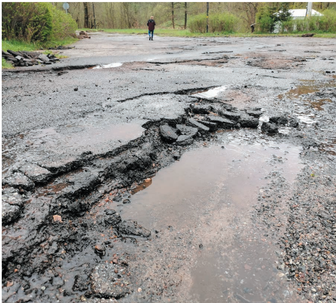
Stan nawierzchni ul. Podgórze już dawno kwalifikował ją do remontu. Po ostatnich podtopieniach pogorszył się dramatycznie
