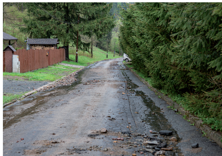
Ul. Podgórze już dawno kwalifikowała się do gruntownego remontu, a po podmyciach z 13 maja br. jej stan jest katastrofalny. Gmina posiada środki na jej modernizację, a przetarg na prace zostanie ogłoszony niebawem
