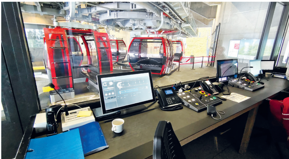
Tak wygląda sterownia nowoczesnej kolei gondolowej
